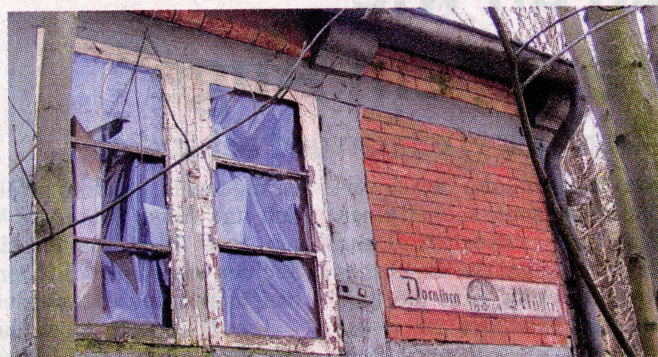
Sämtliche Fenster des Mühlengebäudes sind mehr oder weniger zerstört.
