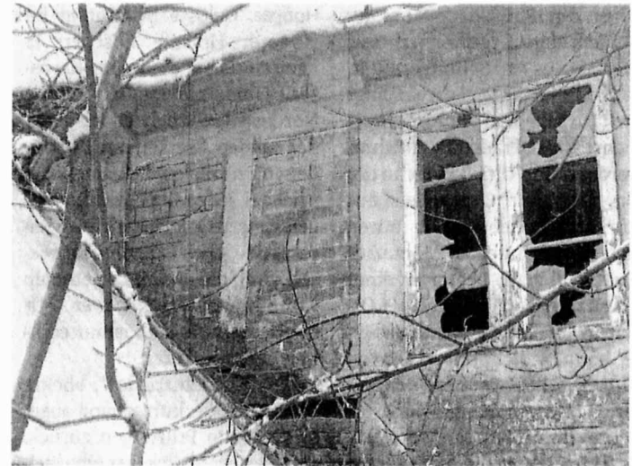
Die Mühle in Seppensen aus dem Jahr 1730 ist nicht nur von der Zeit, sondern auch von Vandalismus geprägt worden. Foto: es
